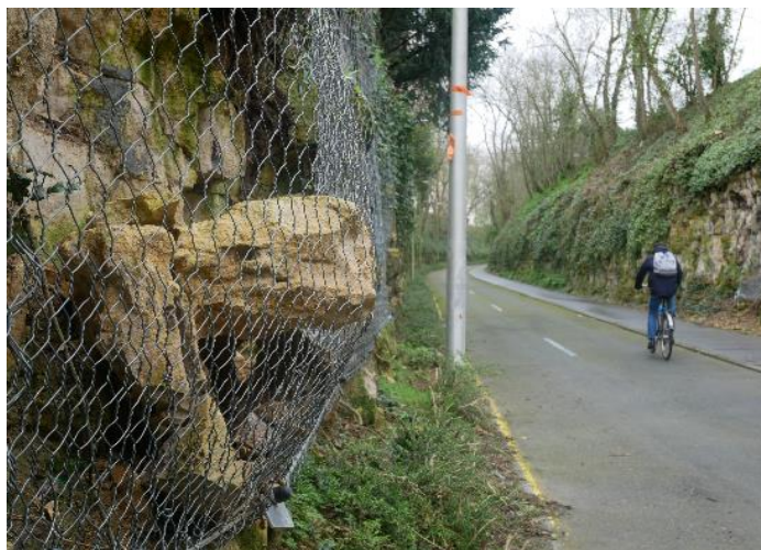
Décrochement rocheux neutralisé par grillage
