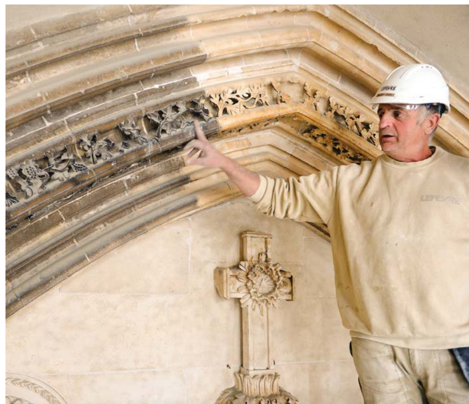
Comme en témoigne cet avant/après, les restaurateurs du clocher redonnent son éclat à la pierre de Caen.
